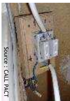
Source : CALL PACT Installation électrique défectueuse
